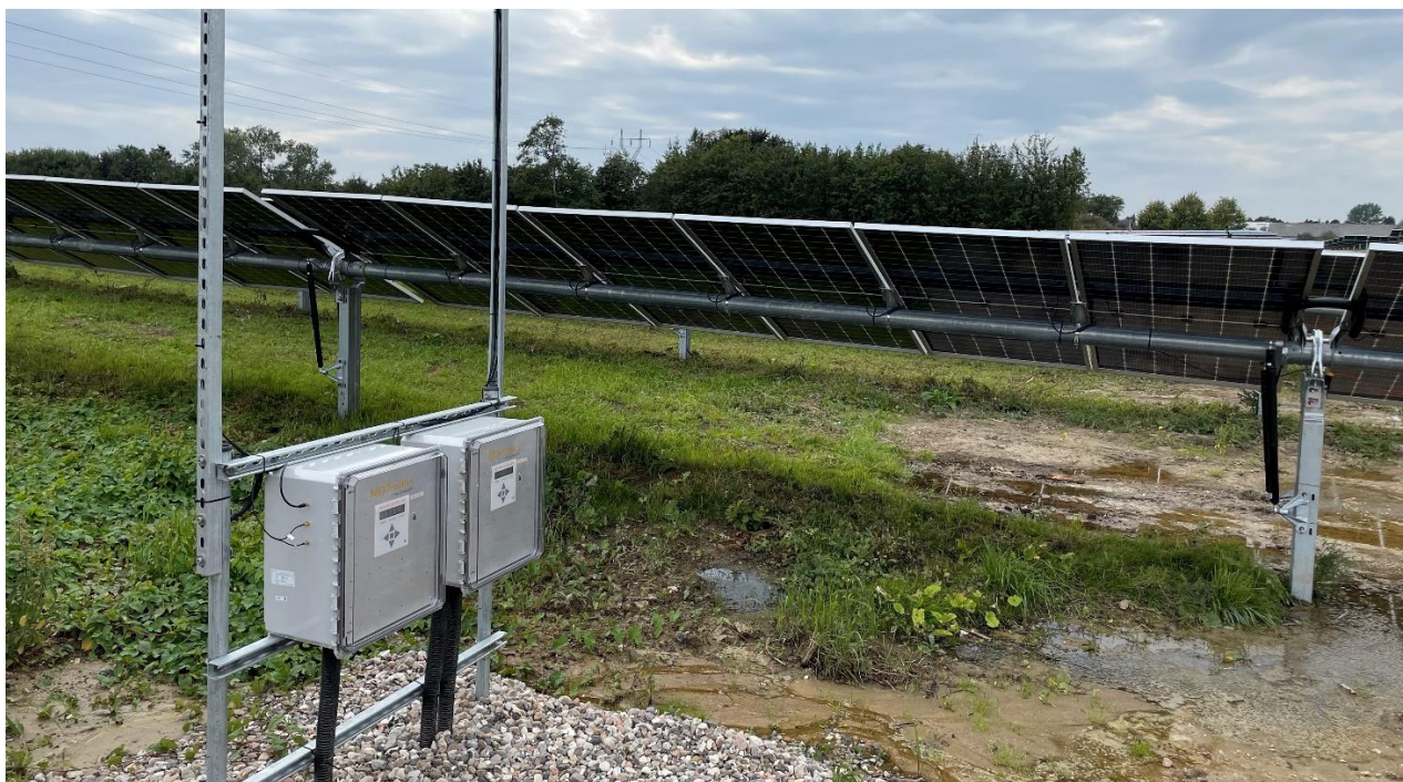
Figur 9: Eksempel på tekniske installationer mellem panelerne.
